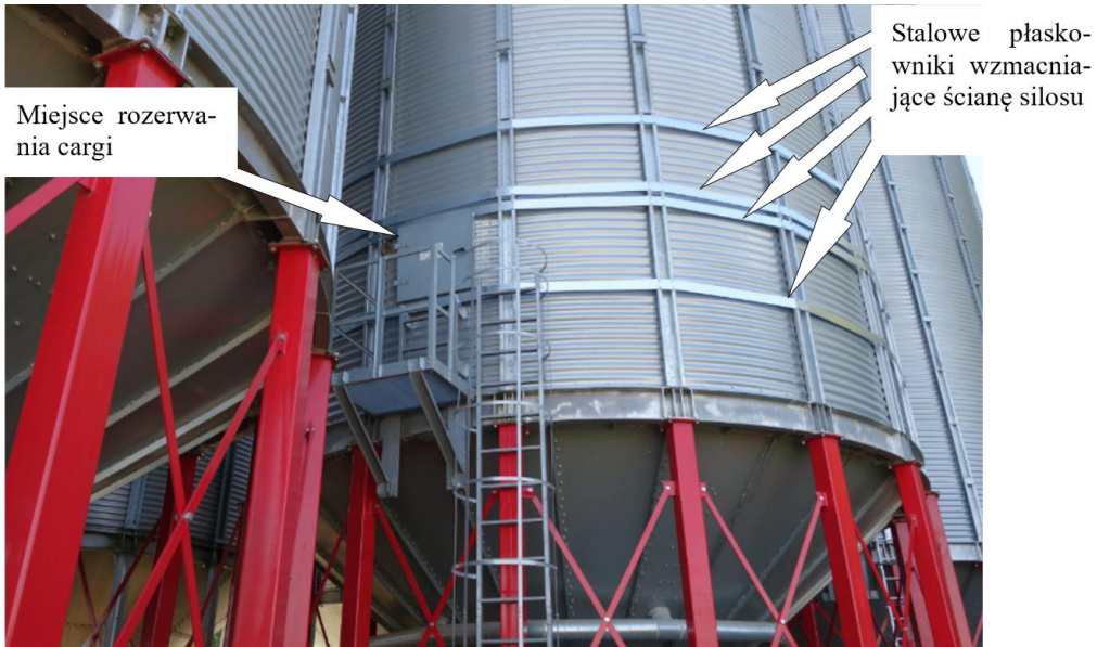
Rys. 1. Widok dolnej części uszkodzonego silosu.
